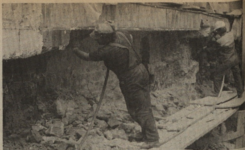
Čeprav so delavci tozda GE Maribor pravilno odstranjevali stare zidove, je sosednja, že dotrajana zgradba, popokala.
