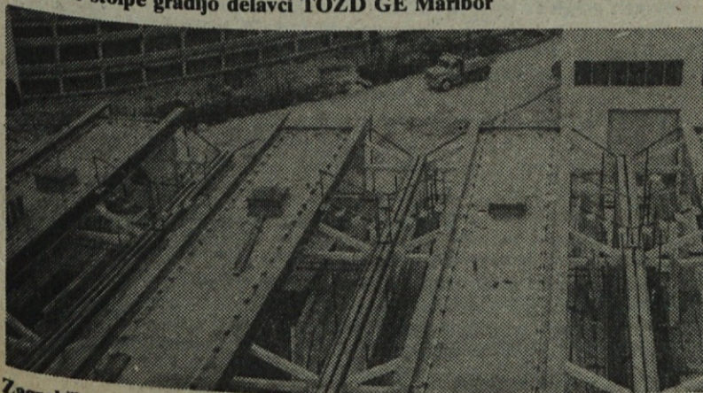
Zagrebška Metalogradnja zaostaja z deli na strehi servisnih delavnic, tako da zaradi tega nastaja precejšnja škoda v notranjosti objekta
