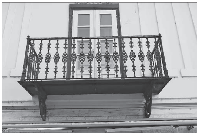
Slika 14: Konzolni balkon hiše št. 13 na Trgu svobode v Slovenski Bistrici (foto: Simona Kermavnar).
