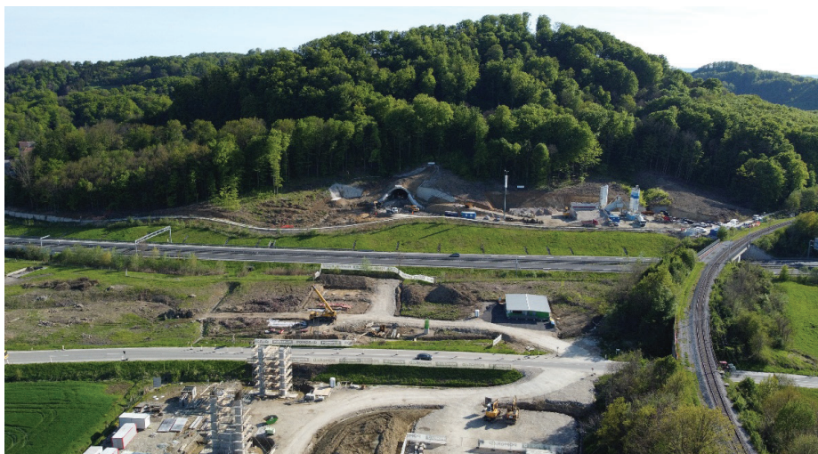
Slika 1 • Severni portal predora Pekel, avtocesta A1, regionalna cesta, obstoječa železniška proga, viadukt Pesnica – stebri v osi 6 in 7, maj 2021.
