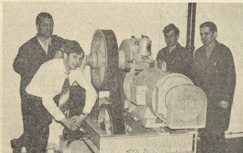
Ekipa, ki je delala na montaži novega dvigala v skladišču gotovih izdelkov
