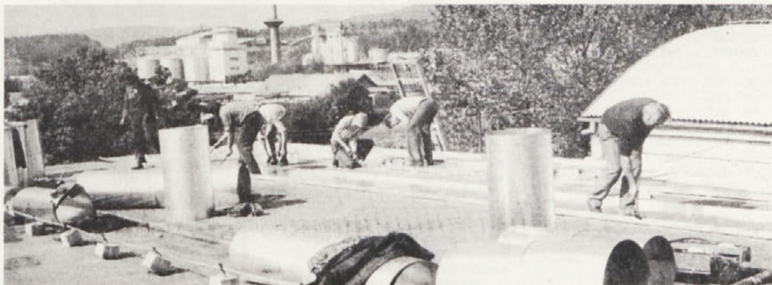
Ker je dotrajana streha nad konfekcijo že nekaj časa močno puščala in so bile delavke ob vsakem nalivu mokre, so jo delavci Novomontaže ob pomoči IVS pričele pred dnevi obnavljati. Pokrili so jo s pocinkano pločevino, vsa dela pa bodo veljala 400 tisočakov. Na sliki: delavci so pričeli pokrivati streho nad konfekcijsko halo.
