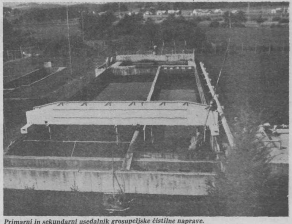
Primarni in sekundarni usedalnik grosupeljske čistilne naprave.
