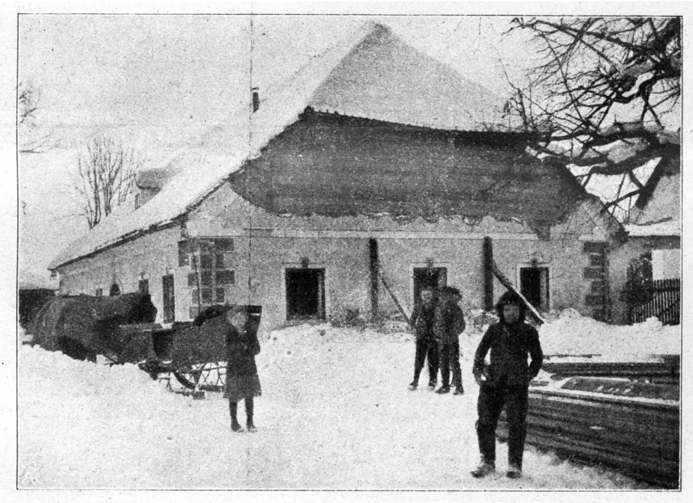
Slika 21: »Hiša župana Ajstra v Krški vasi. Na sliki se vidi od potresa izbit požarni zid, ostala stena je z opornimi stebri podprta, odprtina pa zadelana z deskami. To delo so opravili pionirji. Notranjost hiše je vsa razsuta in so vse stene in stropi podprti z opornim stebrom« (Ilustrirani glasnik, 15. 3. 1917).
