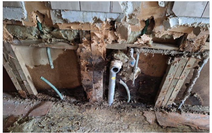
Sliki 5 in 6. Navlaženi konstrukcijski elementi, avgust 2023.
