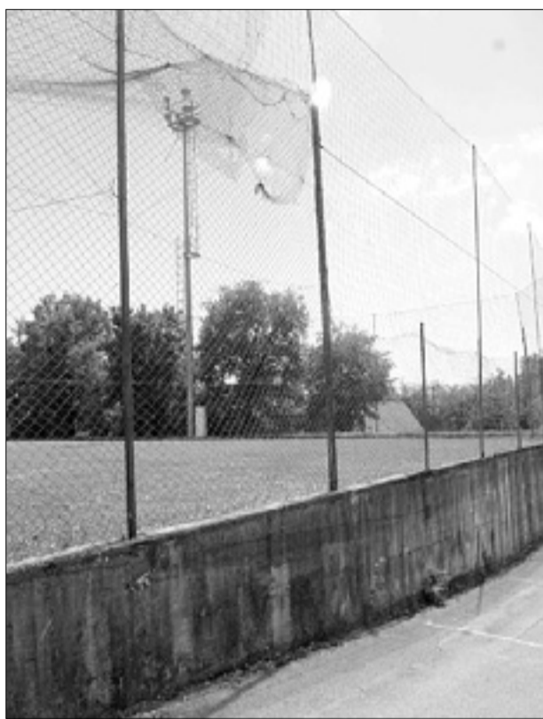
Podporni zid ob nogometnem igrišču v Doberdobu je potreben prenove
