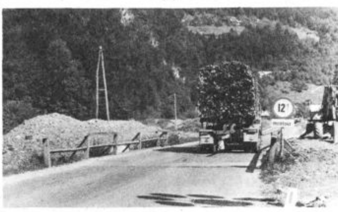
Poleg slabih cest tudi mostovi zahtevajo nenehna popravila
