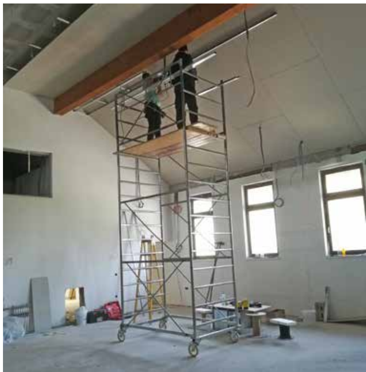
Dela na stropu dvorane – instalacije in druga oprema
