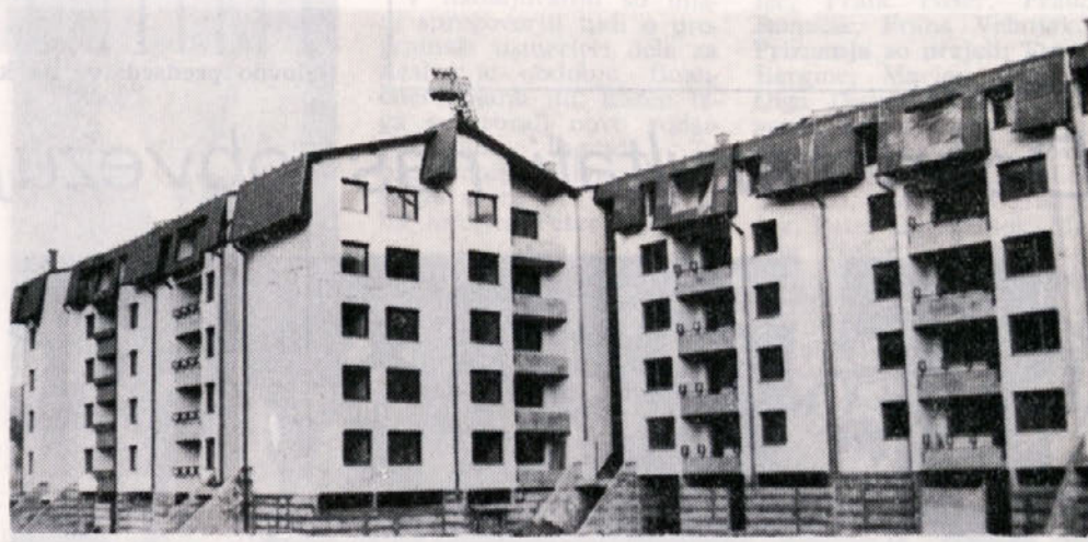
V soseski Debro pri Laškem se izvajajo zaključna dela na 85 stanovanjskem bloku
