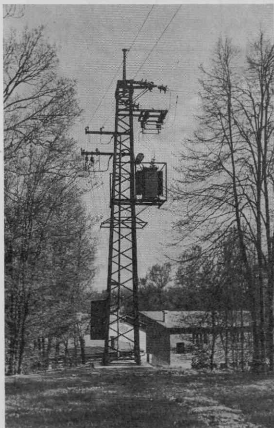
Ena izmed številnih jamborskih transformatorskih postaj
