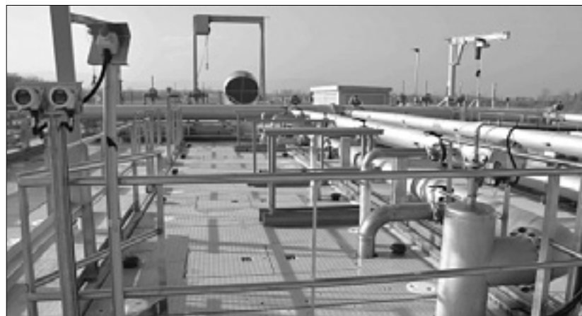
Zunanji del objekta, kjer poteka biološko-membransko čiščenje
