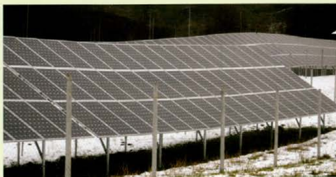
Fotovoltaika pri Dravogradu
