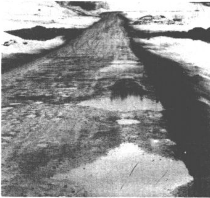
LUKNJE. Krajani Hrastovca, Škal, Plešivca, Cirkovca, ki se vozijo po takšni cesti se upravičeno jezijo. Na cesti zaradi ugrezanja ni asfaltne prevleke. Tisti, ki so obljubljali, da jo bodo sprosti skrbno vzdrževali, pa te obljube ne držijo. Čeprav je na vsaki strani pesek, pa ga zmečejo na cesto šele po tem (če ga?), ko sonce vodo v luknjah že izsuši.
