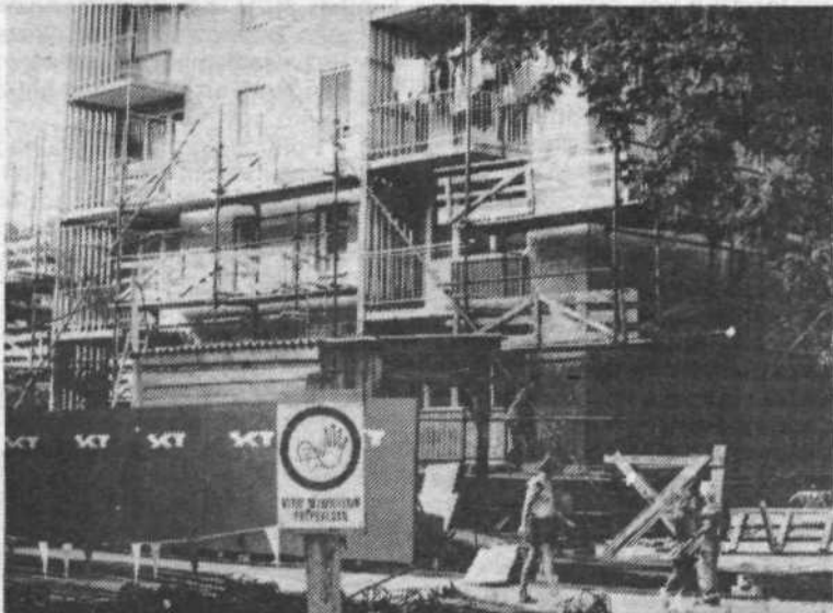
Ko so odprli temelje in odkopali omet, se je pokazalo, da je stanje še znatno slabše, kot so kazale zunanje razpoke in poškodbe. Odkrili so celo mesta brez malte oziroma betonskega veziva in ni čudno, da je nekdo ob takem odkritju v vhodni veži napisal z velikimi črkami »Sramota!«.
