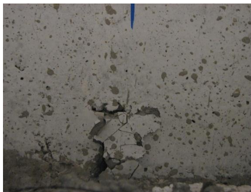
Slika 3.95: Začetek delaminacije betona na notranji strani zaradi uklona vzdolžne palice (Z)
