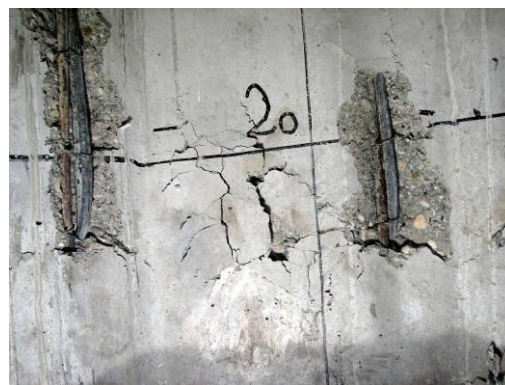
Slika 3.40: Odpadanje betona ob uklonu armaturnih palic na notranji površini stebra NDŠS pri pomiku \Delta = 100,0 mm
