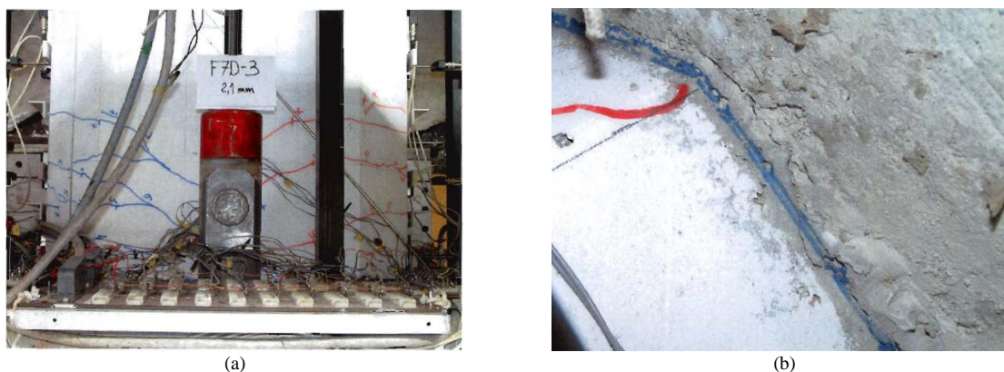
Slika 3.16: (a) Razpoke na zgornji površini ob vpetju stebra po končani sedmi fazi obremenjevanja in (b) Razpoka vzdolž stika stebra s temeljem v prvem ciklu desete faze (Bevc 2006a)
