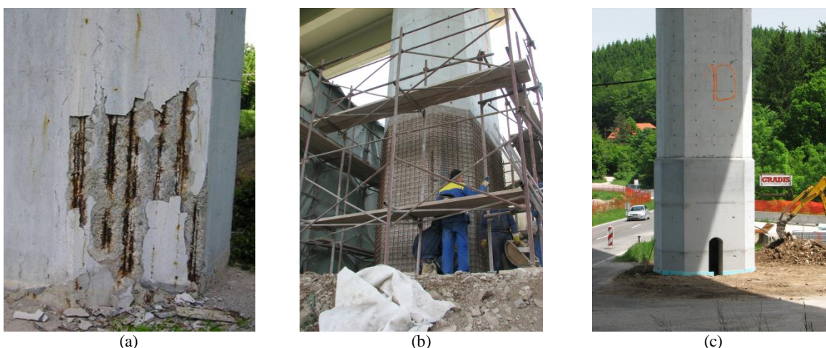
Slika 3.2: Stanje stebrov viadukta Ravbarkomanda pred sanacijo (a); Izvedba utrditve (b); Primer daljšega stebra po utrditvi (c) z betonskim plaščem
