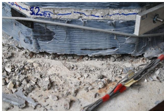
Slika 3.91: Po končani fazi 12: Odrpna razpoka tik ob vpetju stebra (V) Figure 3.91: After phase 12: Crack at the pier base (E)
