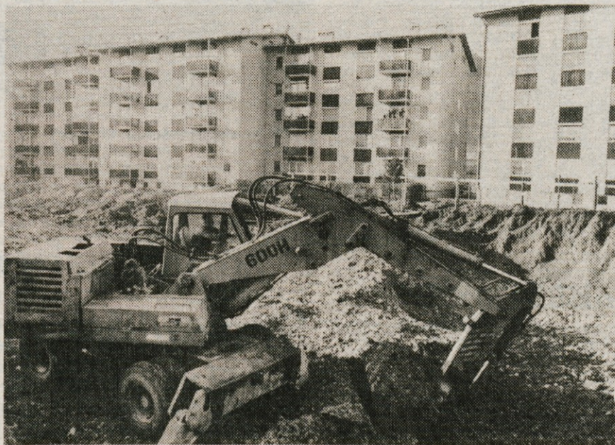
Tržič — V Bistrici pri Tržiču so že zasadili prve »lopatke« za skladišče občinskih blagovnih rezerv. Družno ga gradijo delavci Gradbinca in SGP Tržič, denar pa ob pomoči bančnega posojila združujeta skupščina občine in Mercator. Skladišče bo predvidoma naréd konec poletja. — Foto: F. Perdan
