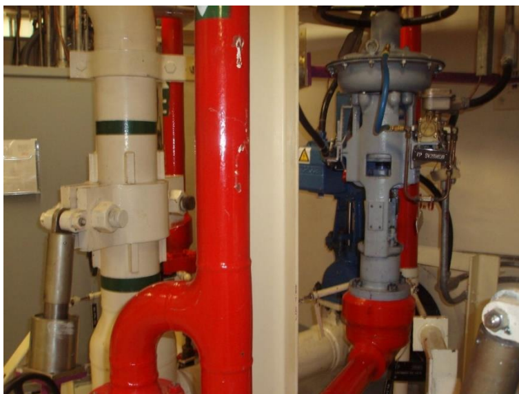
Slika 80: Penetracija zadrževalnega hrama, ki med remontom 2019 v času premikanja goriva ni bila zaprta in pripadajoči izolacijski ventil (Foto: inšpekcija URSJV)
