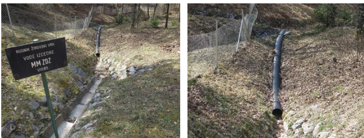
Slika 99: Merilno mesto ZDZ (prememitev zaradi plazov poškodovanega (dvignjenega) kanala iz betonskih kanalet (foto: RŽV)
