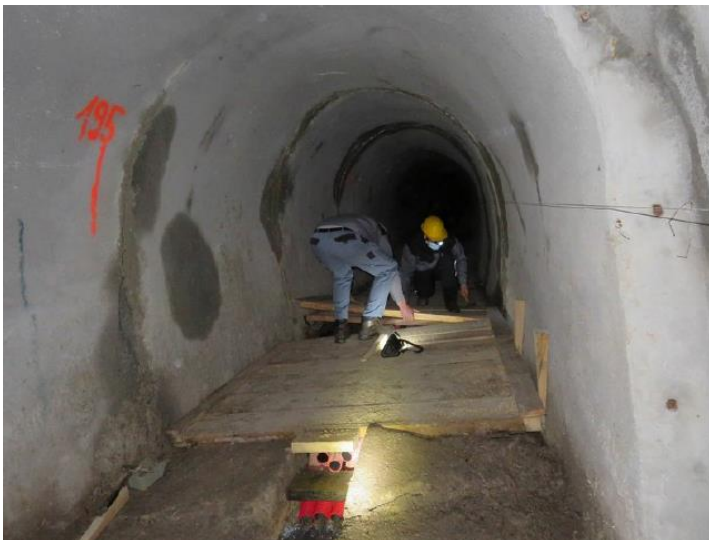
Slika 93: Meritev delovnih pogojev pred vstopom v drenažni rov in sanacija poškodb na mestu prehoda drenažnega rova skozi drsino plazu (foto: RŽV)
