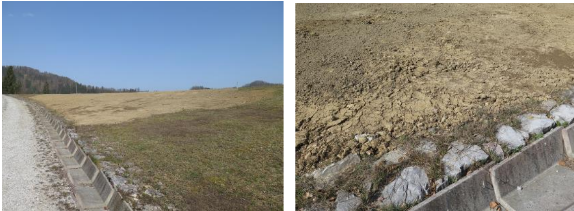
Slika 97: Konec leta 2018 se je ob zgornji cesti pojavila udorina globine do 0,25 m, jeseni 2019 je bilo stanje sanirano (foto: RŽV)
