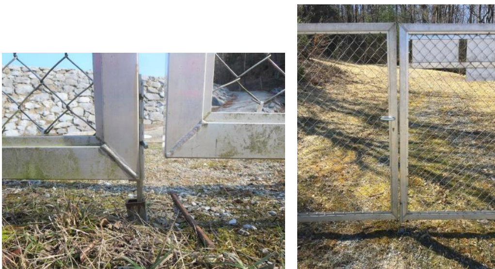
Slika 100: Vhodna vrata na severni dostopni cesti (zamik zaradi plazanja), stanje 2018 , stanje v letu 2020 (spodaj) (foto: RŽV)
