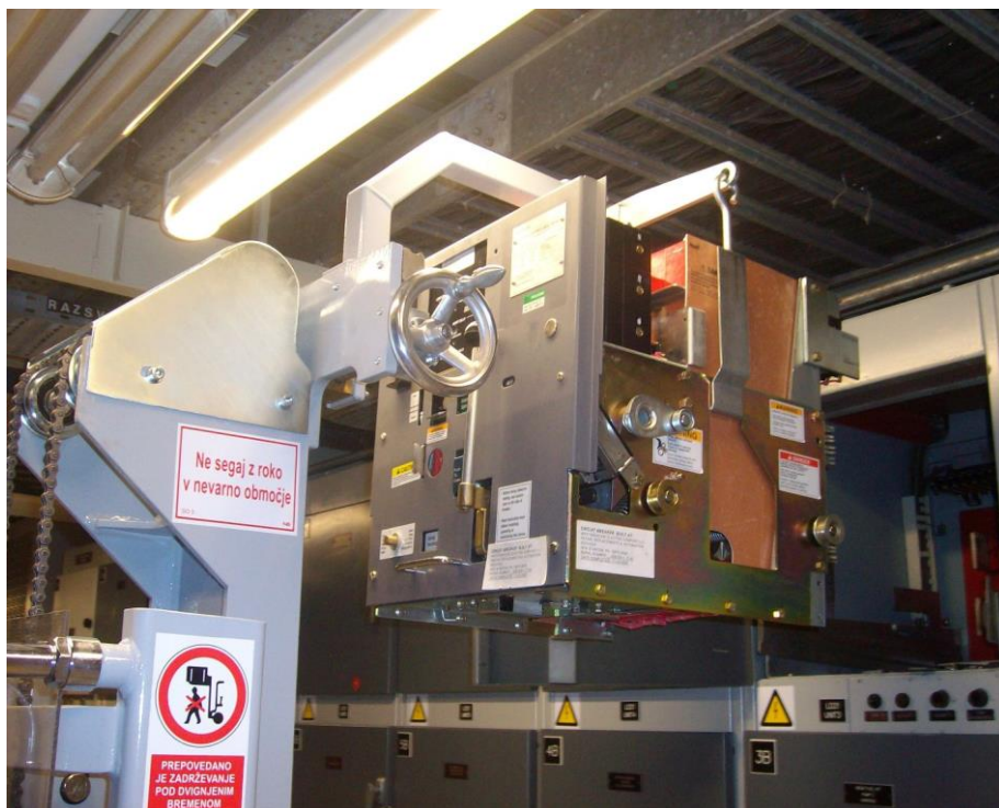
Slika 76: Manipulacija s 400 V odklopnikom črpalke hladilne vode za klimatizacijo prostorov (Foto: inšpekcija URSJV)
