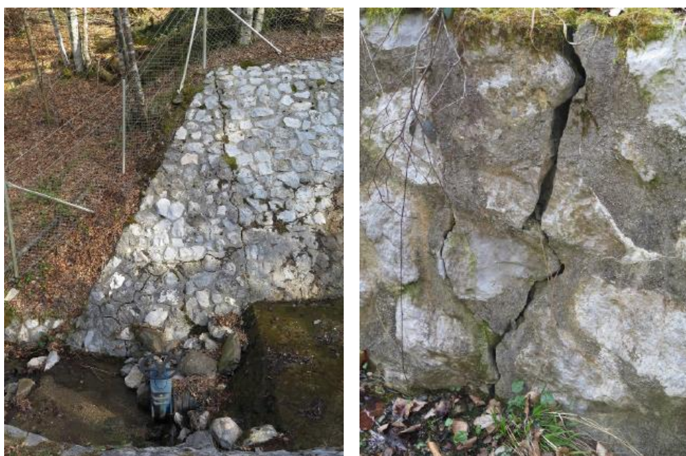
Slika 102: Razpoke na steni ob MM BPG, ena izmed razpok v odvodnem kanalu pod MM BPG, blizu spodnjega naravnega roba plazju. (foto: RŽV)
