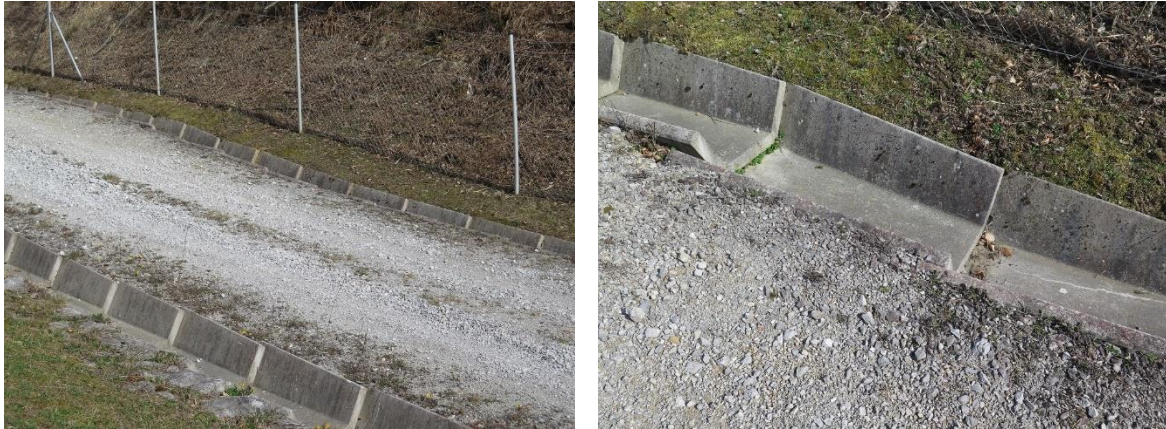
Slika 96: Zgornja cesta na odlagališču Boršt – južni del odlagališča, mesto posedka ceste (levo), zamik kanalet (desno) (foto: RŽV)
