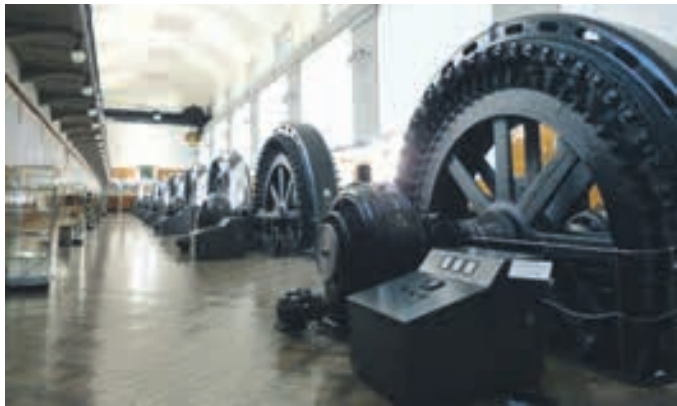
Pogled na del strojnice Muzeja hidroelektrarne Fala z agregati iz leta 1918. Foto: Jerica Škrj
