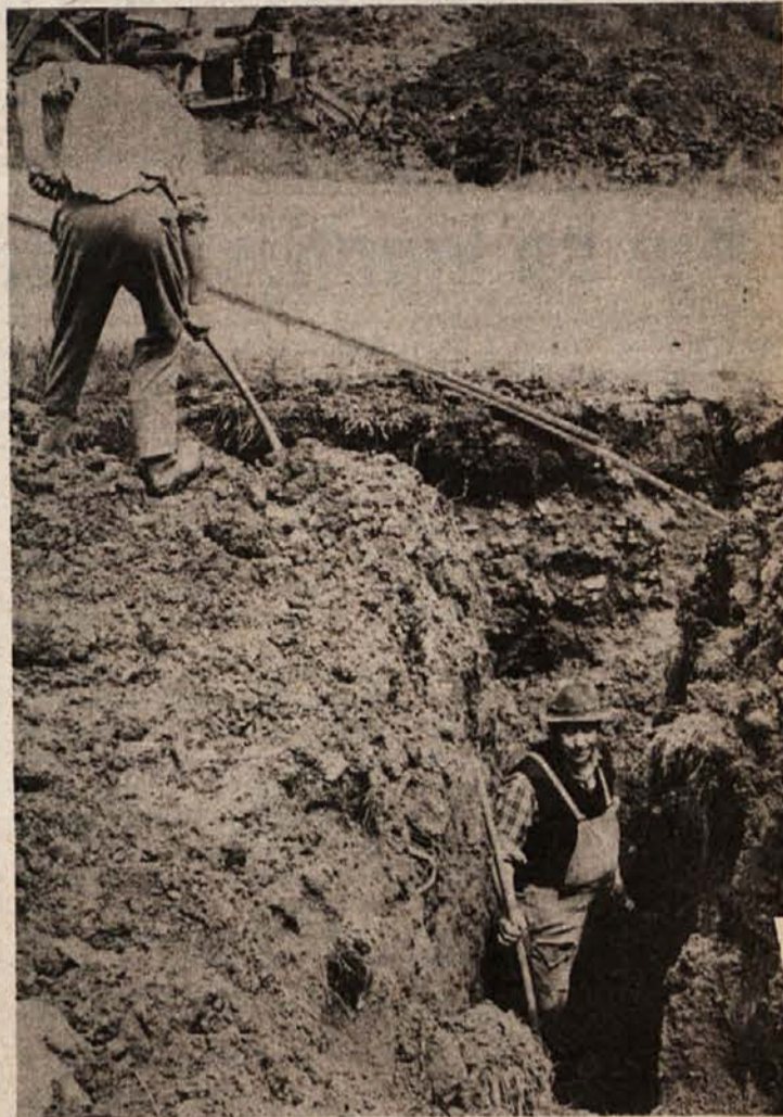
SAMI ZA VODO - Tudi krajanji Pljuske si prizadevajo za zdravo pitno vodo. Zadnja ovira za cevovod do vasi je bila avtocesta. Minuli teden so sicer precej globlje kot je bilo rečeno, našli beton-ske cevi pod cestiščem, da so prišli brez težav na drugo stran. (Foto: Železnik)
