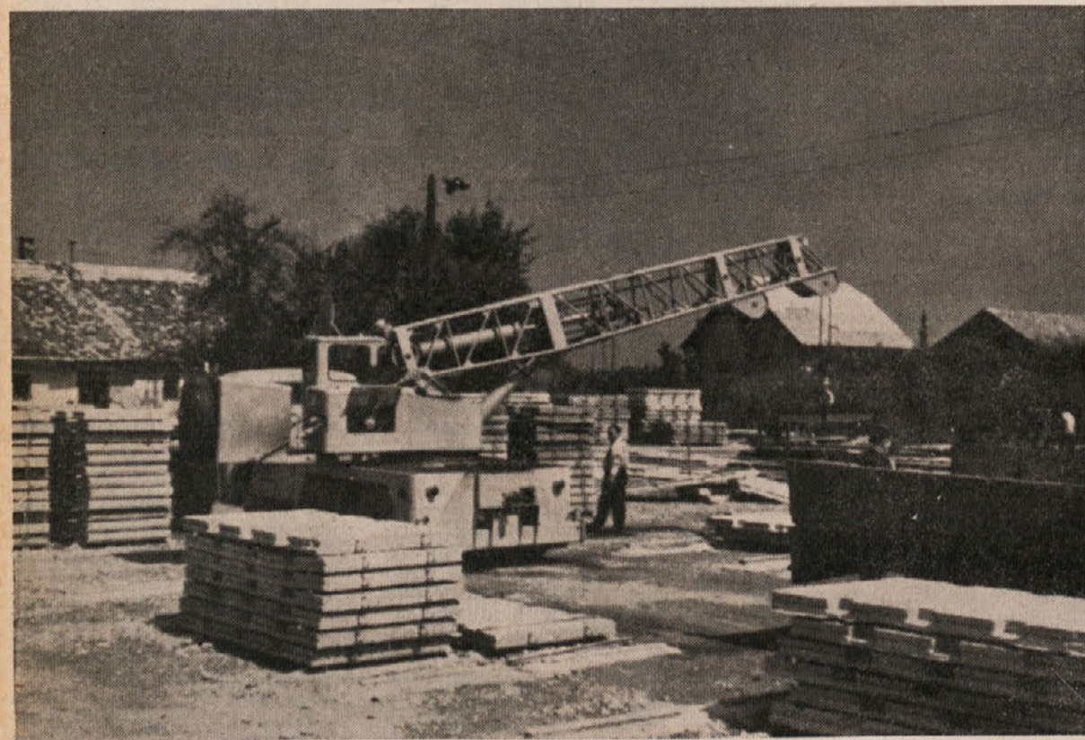
Po nekaj dnevih sušenja se montažne plošče lahko prenesejo v deponijo, kjer so toliko časa, da beton dobi potrebno trdnost. Venlar je treba paziti na oznake, ker bi sicer lahko nastala pri montaži objekta velika zmeda.
