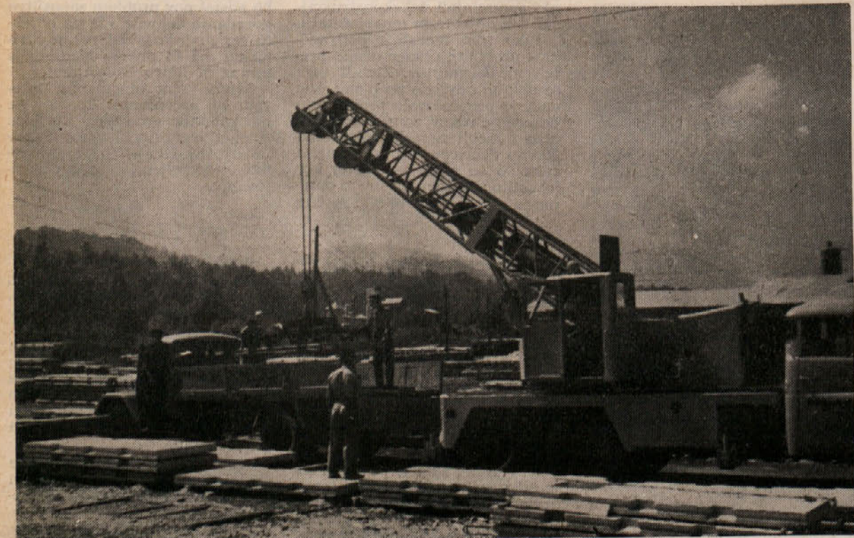
Nova nabavljena mehanizacija zlahka zmore transport vseh komadov iz deponij na objekt, kjer jih že lahko s pomočjo lesenih kondukterjev sestavljajo v posamezne stanovanjske enote
