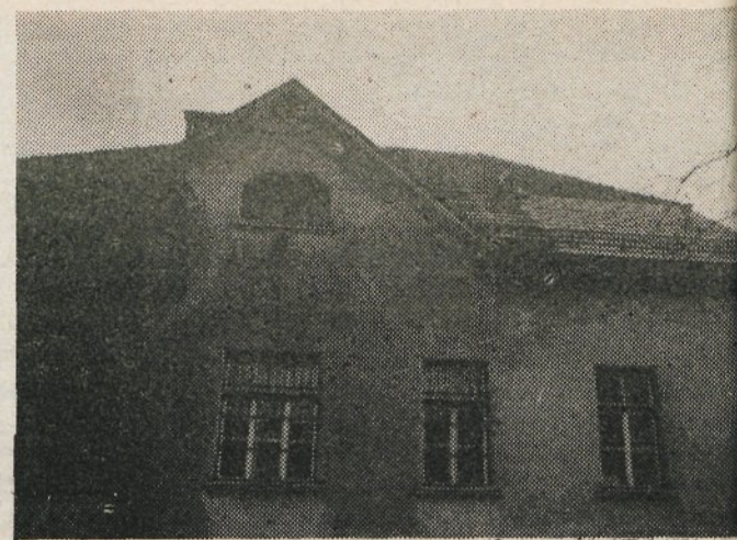
Končno je tudi ligojnska šola dobila del nove strehe in tem bo prav gotovo za nekaj časa rešena propadanje. Dobro se vidijo lise na fasadi, ki so nastale zaradi hude zamakanja, kateremu je botrovala že povsem uničena streha (Fotografija: D. Todorović)
