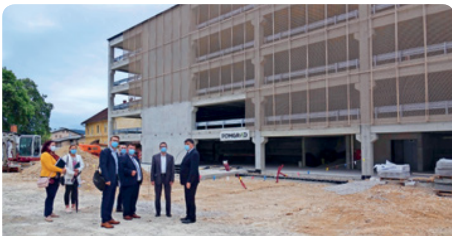
Na ogledu parkirne hiše P+R Grosuplje, gradnja katere je sofinancirana z evropskimi sredstvi
