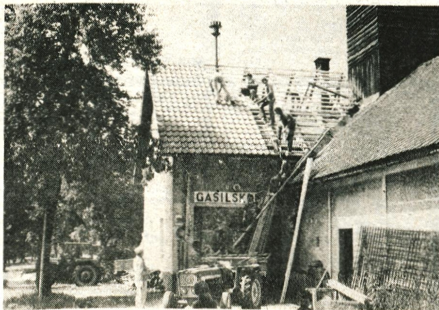
Prekrili streho — Čas je načel opeko na strehi gasilskega doma v Virmašah pri Skofji Loki. Prizadevni člani gasilskega društva so v dobrem dopoldnevu z udarniško akeijo, ki so se je udeležili številni krajanj, streho na novo prekrili.
