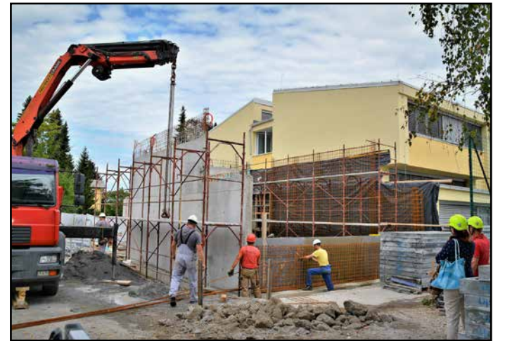
Dozidava objekta 1, kjer bosta dve učilnici, dva kabineta, garderoba in vhod v šolo za nižjo stopnjo.
