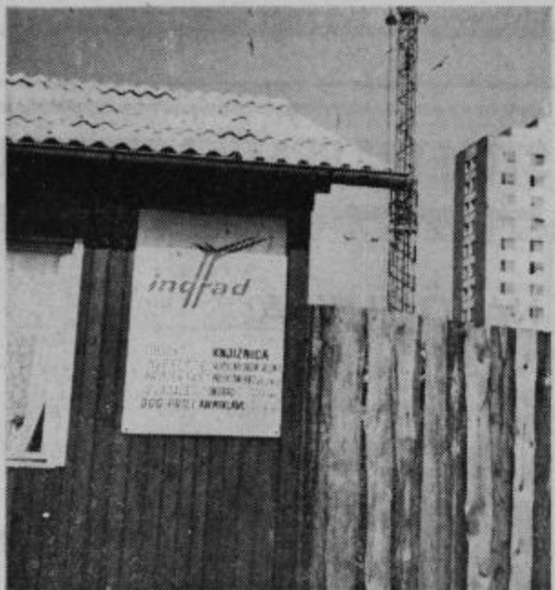
V Velenju je nastalo novo gradbišče. Dela za gradnjo knjižnice so se že začela... — Foto: MB
