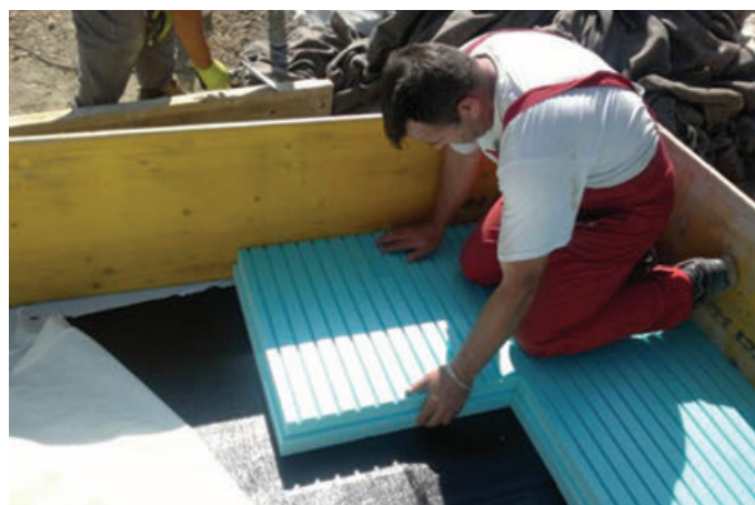
Slika 3: Polaganje drugega sloja XPS, ki sestavlja vrhnji sloj 'seizmične blazine'. Figure 3: Installing second layer of XPS – top layer of 'seismic foundation pillow'.
