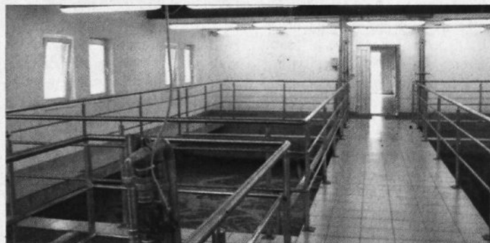
Tehnološki del čistilne naprave
