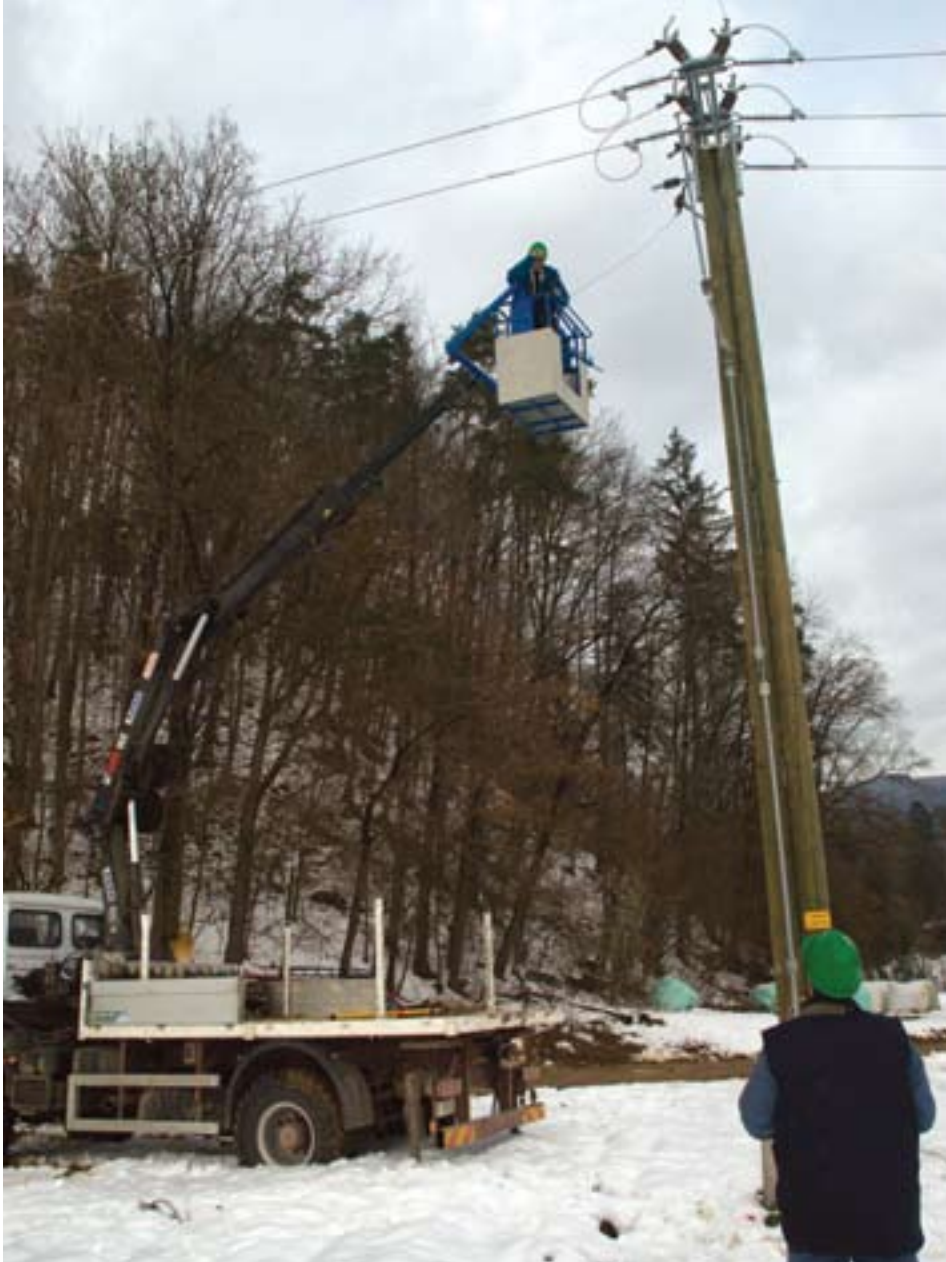
Delavci Elektro Celje so več ur odpravljali težave na omrežju zaradi snega.
