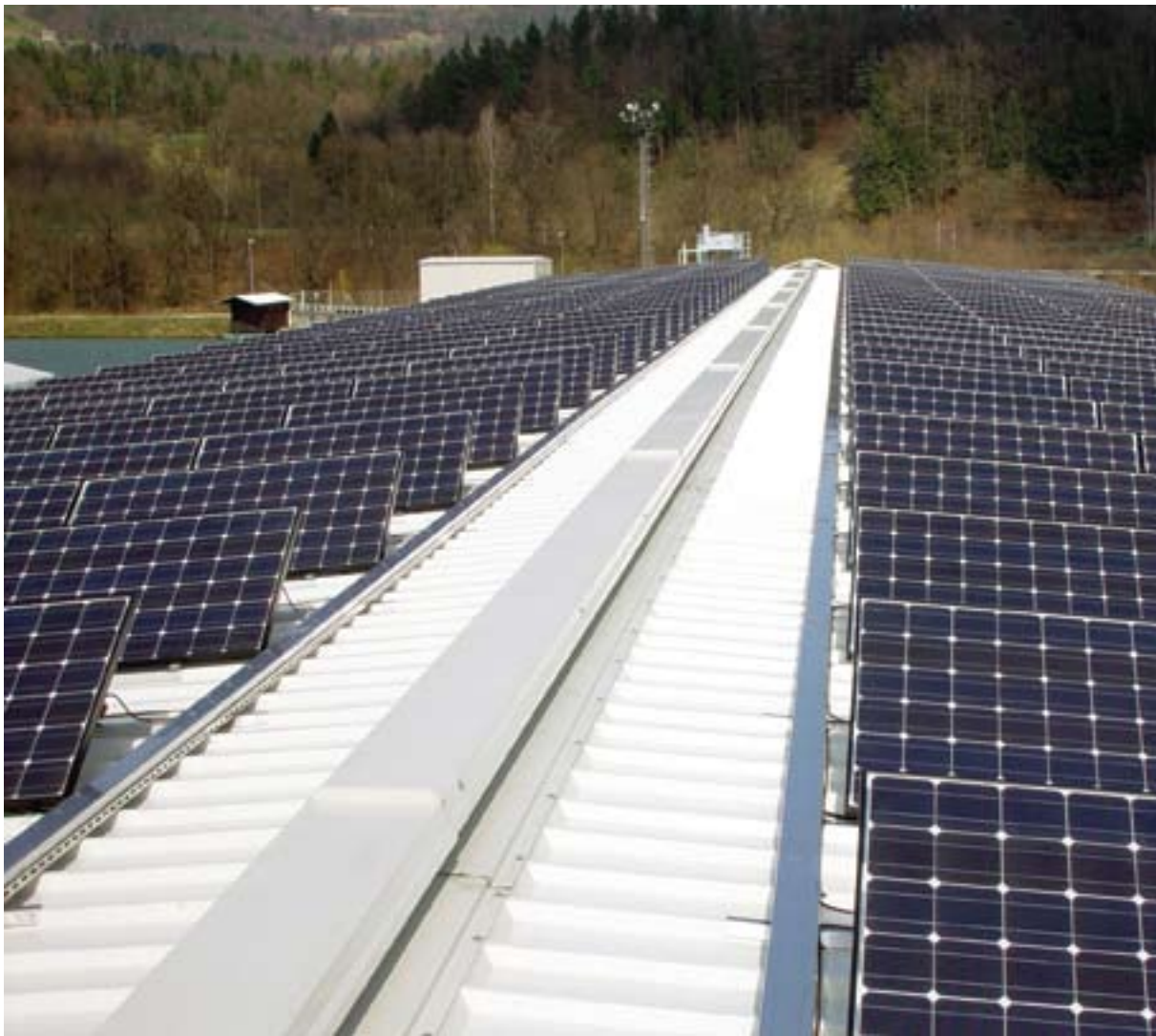
Fotovoltaična elektrarna na strehi HE Vrhovo
