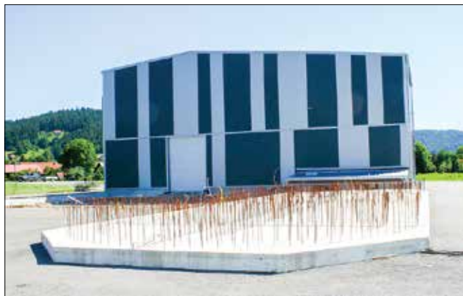
V podjetju Brinečev kmečki mlin so gradnjo novih prostorov zastavili fazno; najbolj se je mudilo s skladiščem, čaka jih še gradnja silosov za žito.
