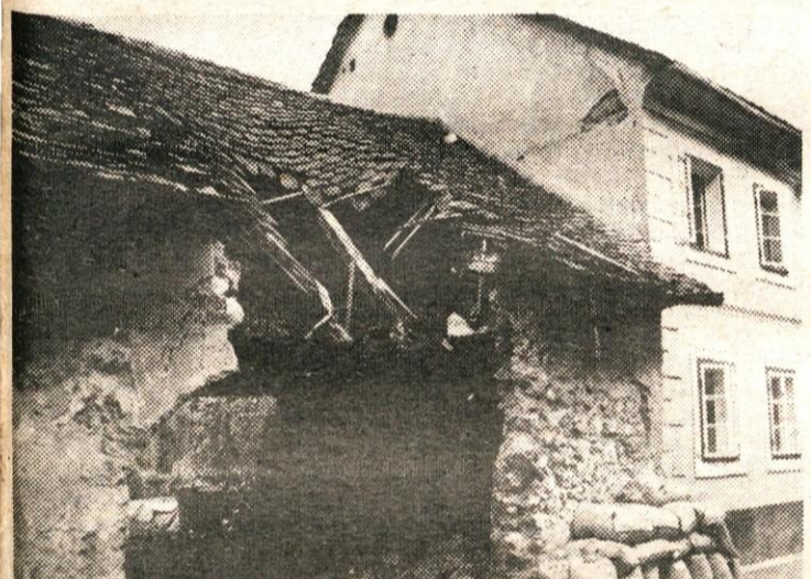
KAMNIŠKE POSEBNOSTI: Okolje nekaterih naših kulturnih spomenikov nam ni ravno v čast. O tem nas lahko prepriča pogled na že precej časa podirajočo se zgradbo ob rojstni hiši književnika Frana Albrehta
