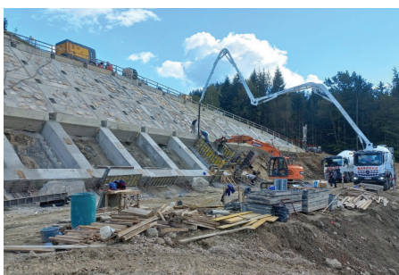
Slika 11. Betoniranje vertikalnega slopa na zgornji etaži oporne konstrukcije 10-OK-40, september 2022 (Foto: DARS, d. d.).
