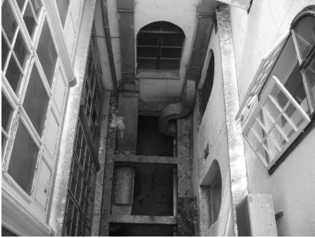
Slika 1: Severni del svetlobnika – pogled od zgoraj
