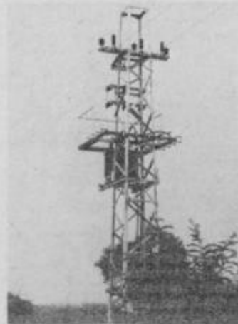
Nova transformatorska postaja v Dragonji vasi.
