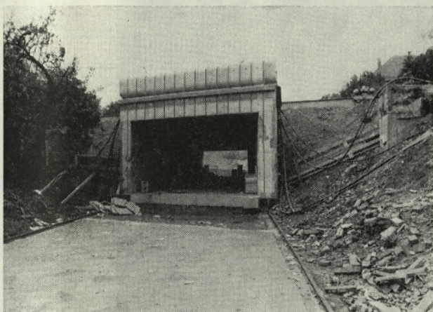
Slika 8. Okvir podhoda na Proletarski cesti v Ljubljani. Okvir je že potisnjen pod tir; v ospredju plato, na katerem je bil zabetoniran
