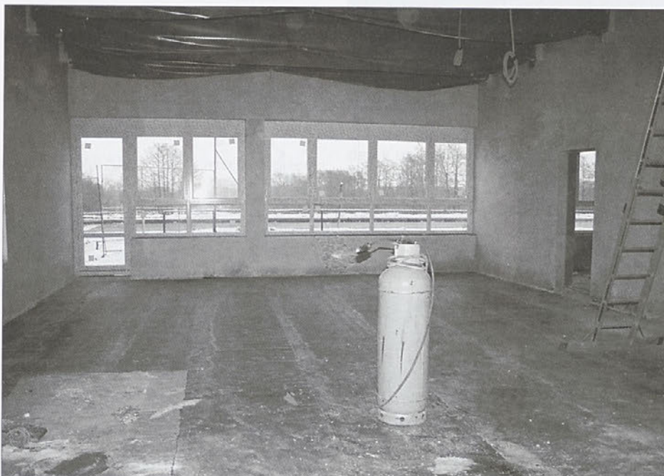
Vgrajeno je tudi stavbno pohištvo in v notranjosti so se pričela že nekatera obrtniška dela.
