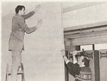
Slogina delavca na montaži v Celju: pri delu sta se dobro ujela, občasno opravljala različna dela na sicer skupni montaži, ob vgraditvah težkih elementov pa sta si seveda pomagala.
