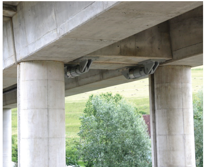
Slika 10. Med okvirji so vgrajene hidravlične naprave za prenos udarnih sil STU 2500 kN (foto: Ponting, d. o. o.).
