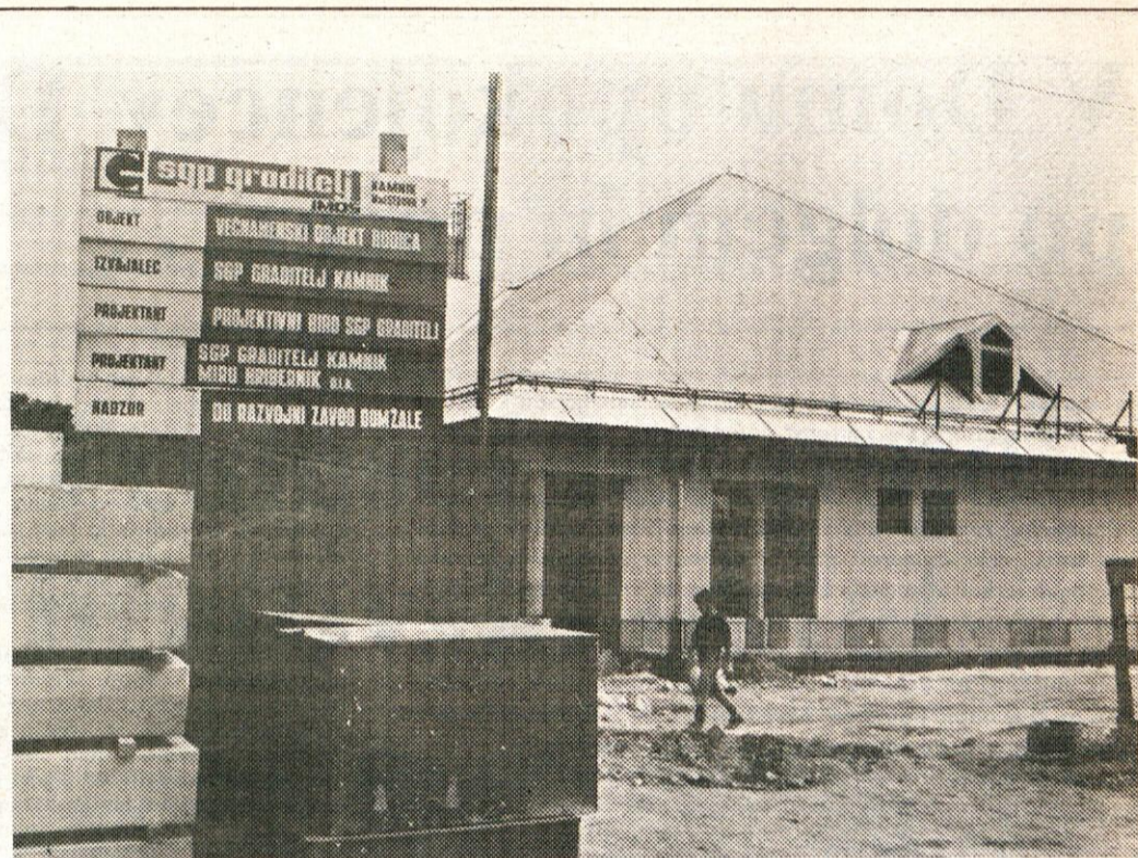
Večnamenski objekt, ki ga gradijo na Rodici, počasi že dobiva svojo končno podobo. V tej stavbi bo nova rodiška trgovina.
