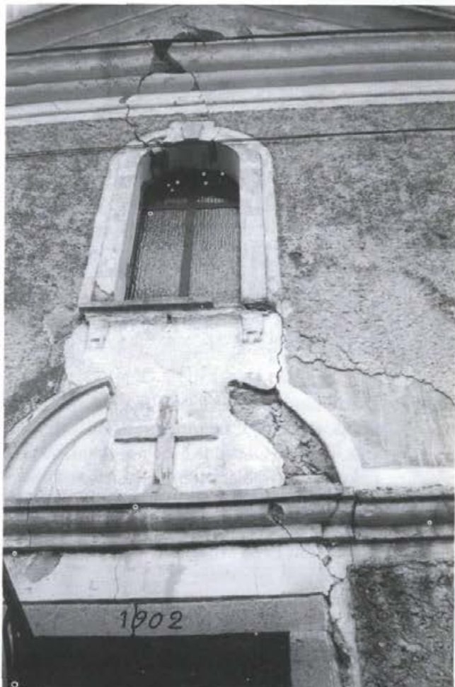
Razpoke na pročelju cerkve sv. Roka v vasi Krn
