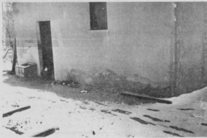
Vežica nima zaradi slabih temeljev vlažne stene.
