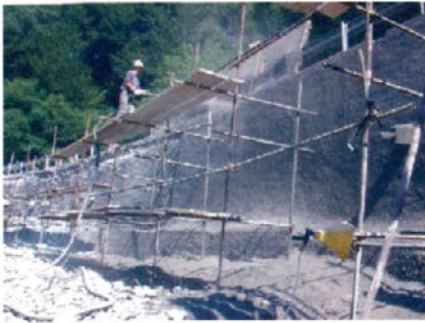
Rekonstrukcija podpornega zidu pod cesto in nad reko Idrijco je bila opravljena po rudarski metodi brez rušitvenih posegov. Po gradbeni metodi zid najprej porušijo in nato betonirajo povsem novega. Naša metoda je cenejša.
