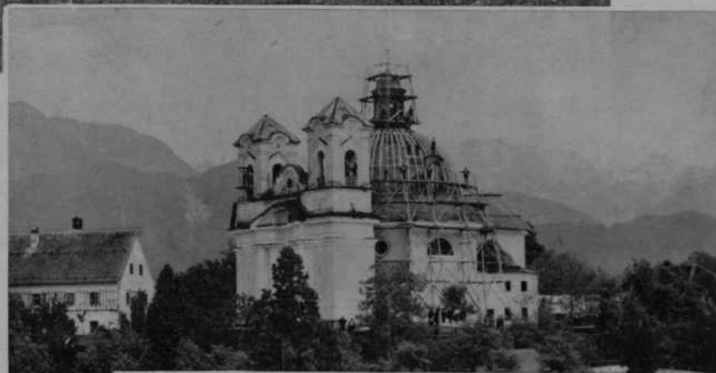
Tunjiška farna cerkev (pri Kamniku) je deloma pogorela. Vneti župljani pa so se takoj lotili dela, da cerkvi vrnejo prejšnjo lepoto. — Slika nam kaže graditev ogrodja za kupolo. Pozneje pride ta na vrsto tudi oba lepa zvonika.
