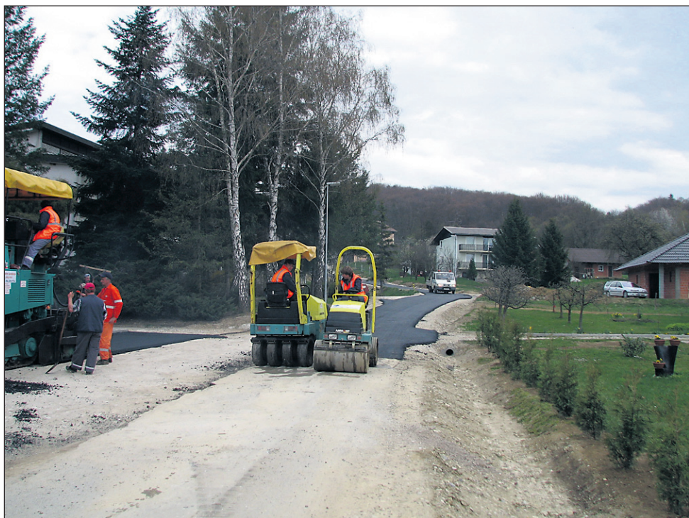
Foto: SM Potem ko so lani položili kanalizacijski vod in nanj priključili 14 gospodinjstev, so zdaj v centru Podlehnik asfaltirali še odsek ceste, ki je bil zaradi izvedenih del uničen.
