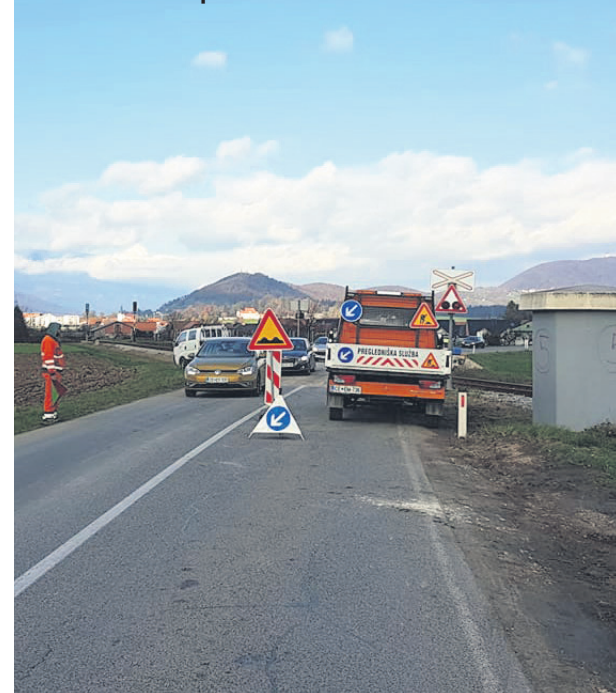
Nivojski prehod na državni cesti med Polzelo in Ločico ob Savinji bo končno dobil zapornice. Foto: Jože Kužnik
