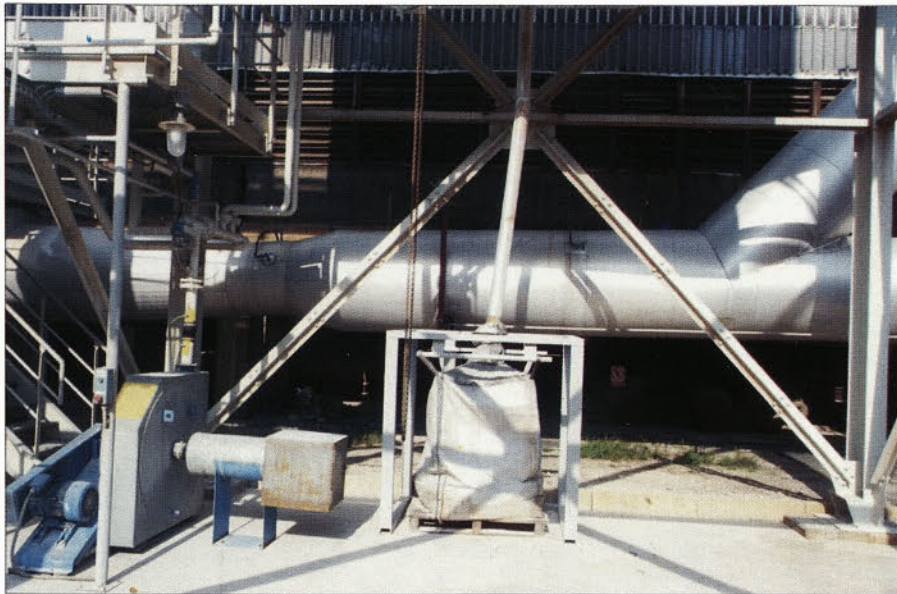
Zajem glinice ob zaustavitvah na čistilni napravi Riedhammer peči
