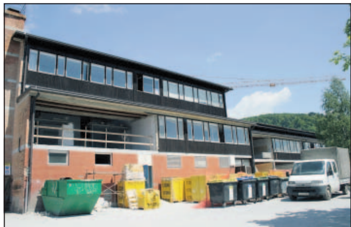
Stropi učilnic oziroma nosilne plošče imajo tako slab beton, da bodo morali čisto vse utrditi z železnimi travervami.
