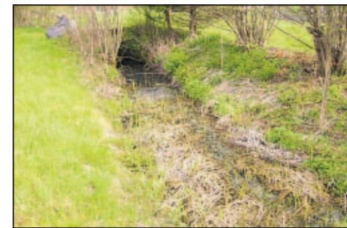
Opuščeni mrtvi odtočni kanal s črno smrdljivo brozgo
