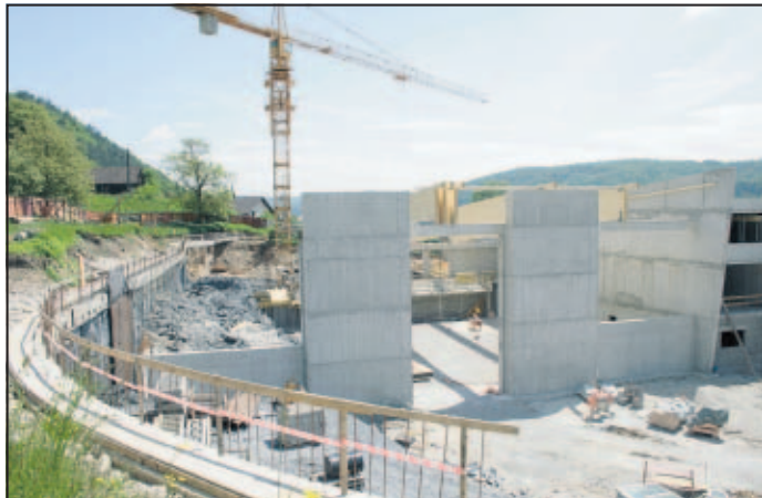
Levo je oporni zid za gradbeno jamo, ki le še s težavo kljubuje neugodnemu terenu. Potreben bo korenit poseg za utrditve stene.
