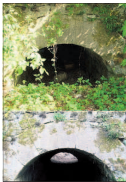
Vodni prepust na Pakem prej in potem
