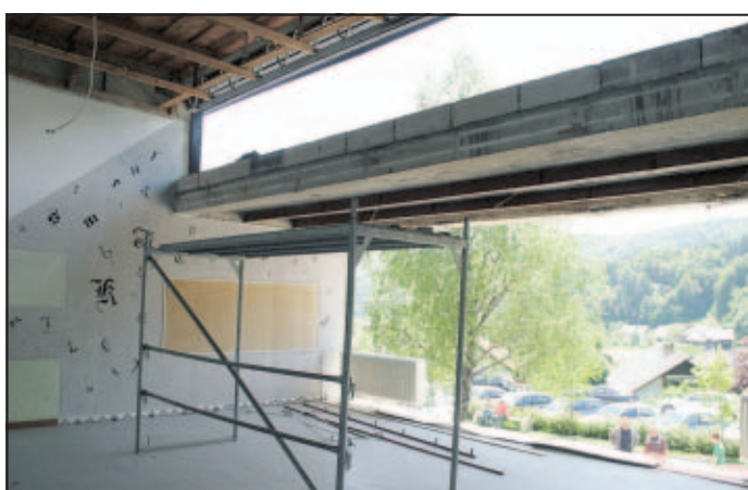
Z večine učilnic so odstranili prednje lesene fronte z okni in se lotili utrjevanja stropov oziroma betonskih plošč.
